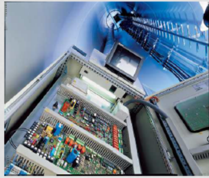
Contrôleur Enercon en pied de mât
