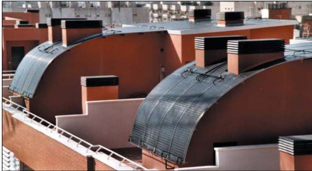
Production d'ECS à l'aide de capteurs non vitrés. © Techniques de l'Ingénieur.
