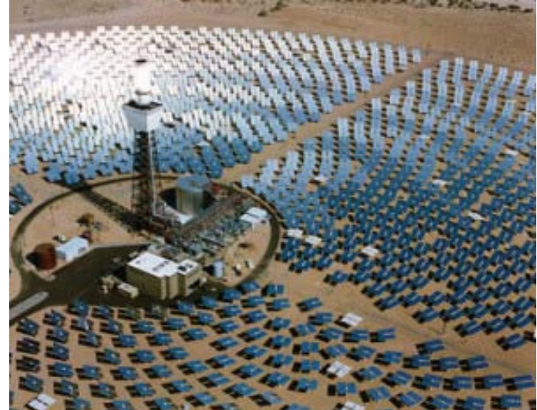
Centrale solaire à concentration → production d'électricité
