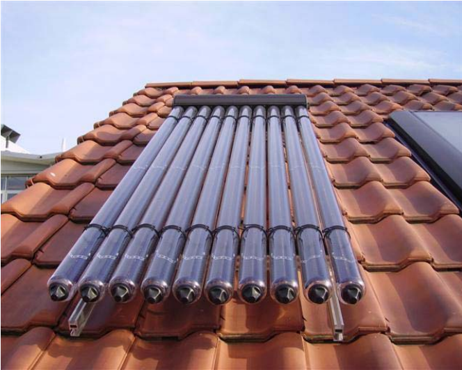
Panneau solaire thermique (tubes sous vide) → eau chaude sanitaire & chauffage
