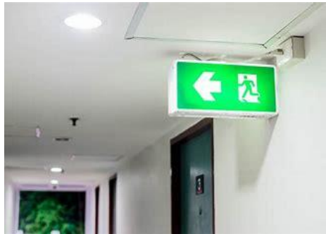
Figure 8: Éclairage et éclairage de sécurité
