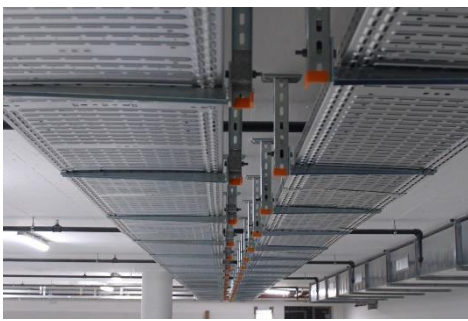
Figure 3: Chemin de câble
