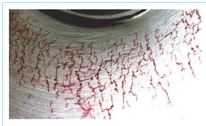
Figure 14 – Faïençage thermique détecté par ressuage (coude d'une tuyauterie d'injection de sécurité)
