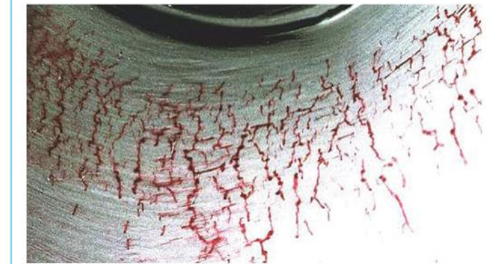
Figure 14 – Faïençage thermique détecté par ressuage (coude d'une tuyauterie d'injection de sécurité)
