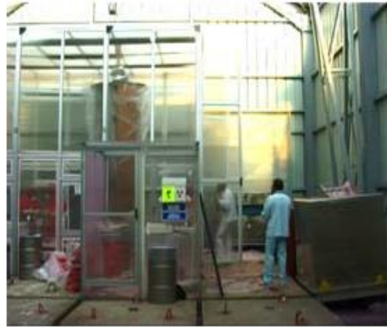
Sortie de l'élément filtrant du sas d'intervention
